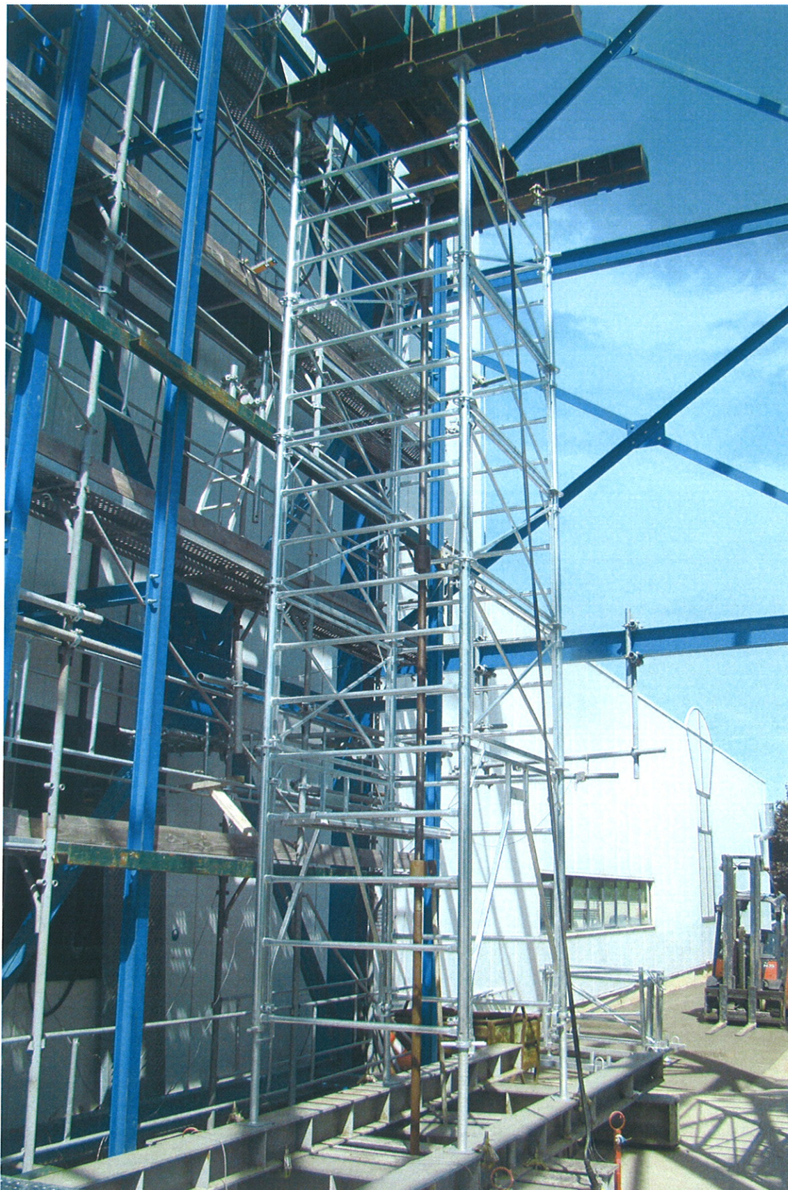
Tour avant essai
